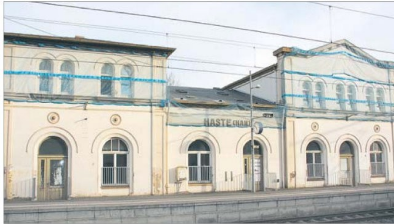
Entrümpelt und entfeuchtet ist das Bahnhofsgebäude bereits. Bald könnte die Sanierung folgen.
